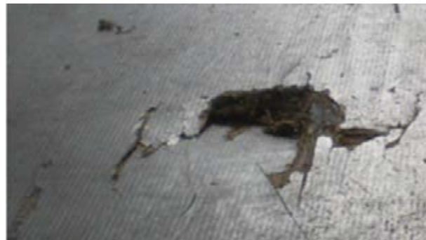
Piso: Deformaciones o perforaciones que merece la pena de reparar
