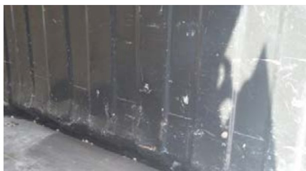
Deformaciones internas: Ligera deformación sin agujeros ni cortes, tiempo de reparación ≤ 3 h
