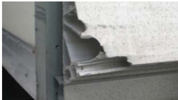
Compuerta de carga: Deformaciones de la plataforma que no merece la pena de reparar, revestimiento roto o incompleto
