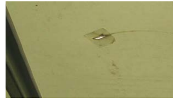
Zona del techo: Perforado o desgarrado que merece la pena de reparar
