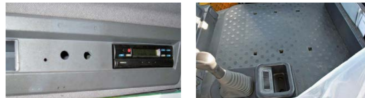
🔧 🔄 Faltan elementos de mando, del asiento o de revestimiento o están rotos o agujereados
