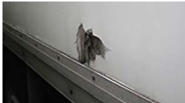
Paneles laterales de madera: Soporte de madera deteriorado \geq 20 cm
